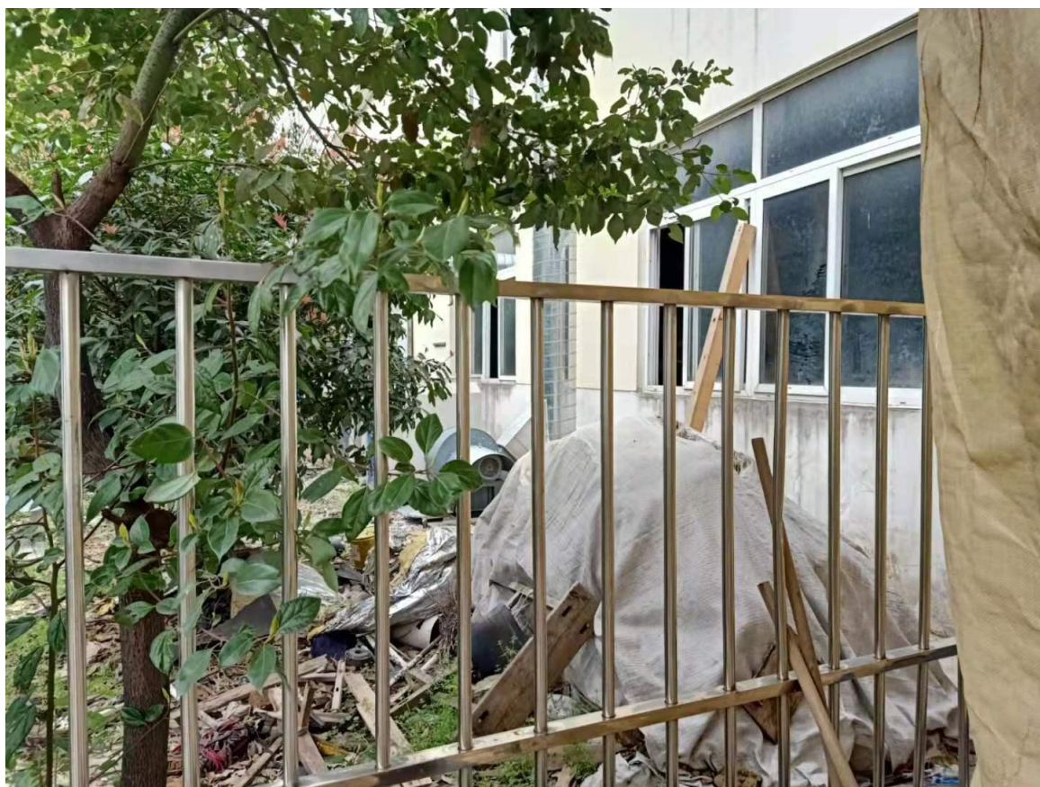
厂区 1 套两级活性炭吸附装置+1 根 15 米高排气筒
